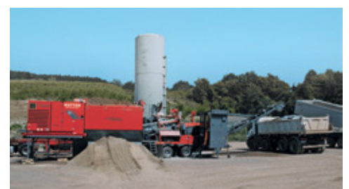
15 MOBILE MISCHANLAGE (KMA)
